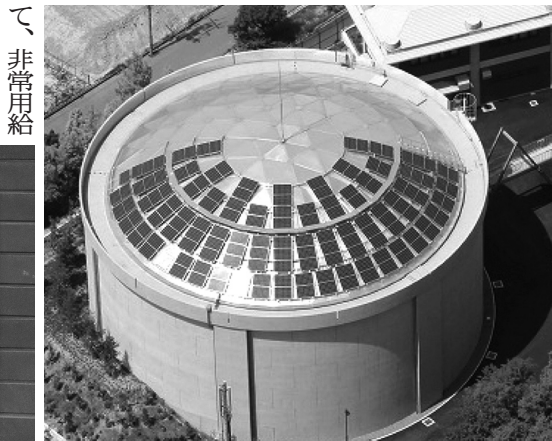
太陽光発電パネルが設置された2号配水池
